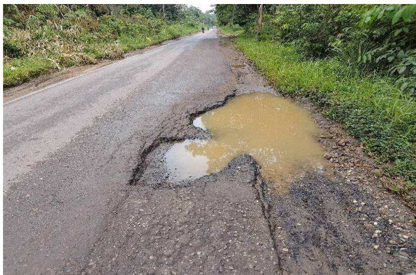
Gambar 2. Kerusakan Tepi Jalan (Edge Break)
