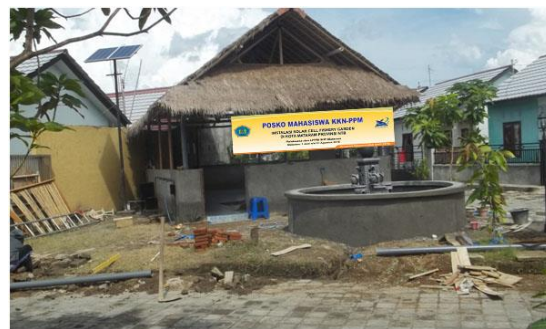
Gambar 3b. Setelah instalasi solar cell FG
