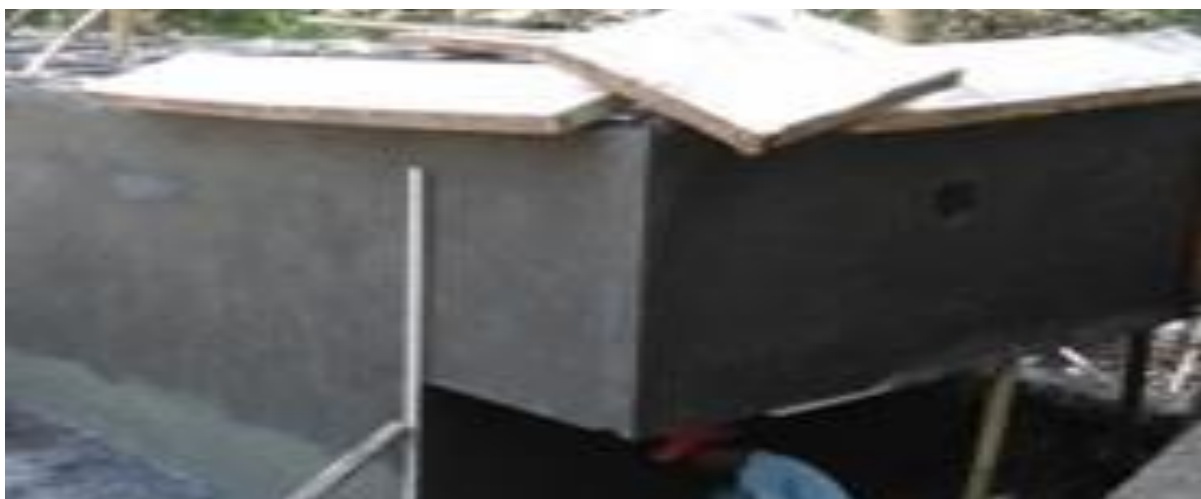
Gambar 3. Bak Penampung Air Hujan
